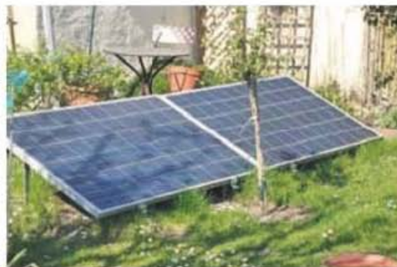
Photovoltaik-Modul aufs Dach, die Garage, in den Garten stellen und einfach den Stecker in die Steckdose stecken. Der in der Mini-Photovoltaikanlage erzeugte Strom wird dadurch direkt in den Stromkreis geführt. stuw-foto
