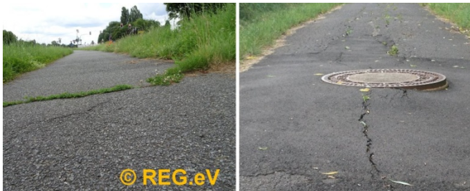
Bild: Fuß- und Radweg Abschnitt Roßdorf bis B38 mit grasbewachsenen Spalten, Abschnitt B38 bis Gundernhäusen mit unangenehmen Kanaldeckeln
