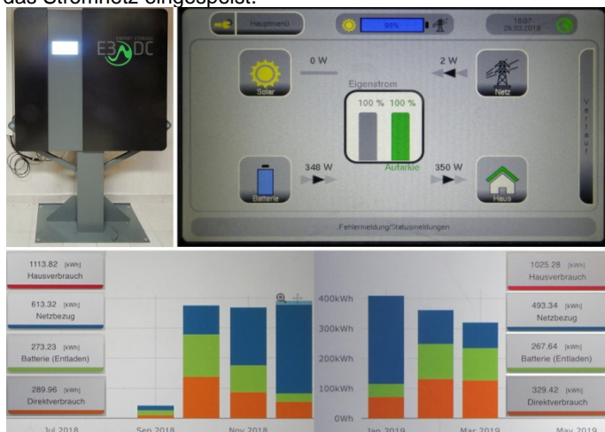
Bild: Hausspeicherkraftwerk E3/DC mit Anzeige im Gerät und die Verteilung des Strombezugs für das Winterhalbjahr 2018/19
