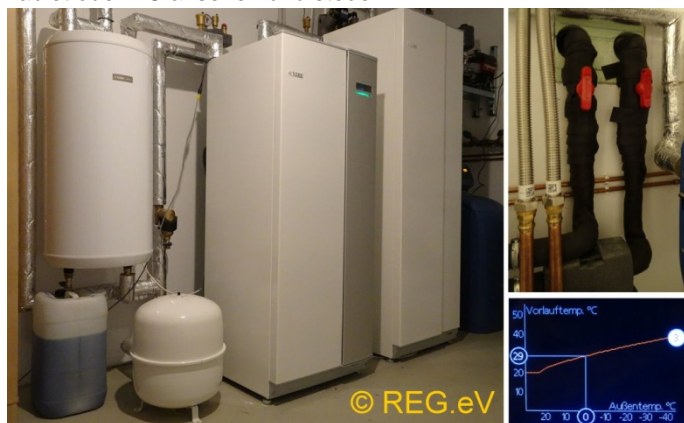
Bild: Erdwärmepumpe mit Puffer- und Brauchwasserspeicher; Zuleitung von außen; Beispiel einer Anzeige am Gerät
