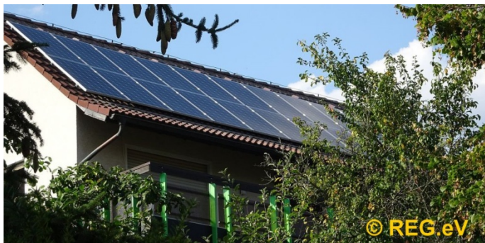
Bild: Fertige Photovoltaik-Anlage mit 22 Modulen und einer Nennleistung von 6,49 kWp
