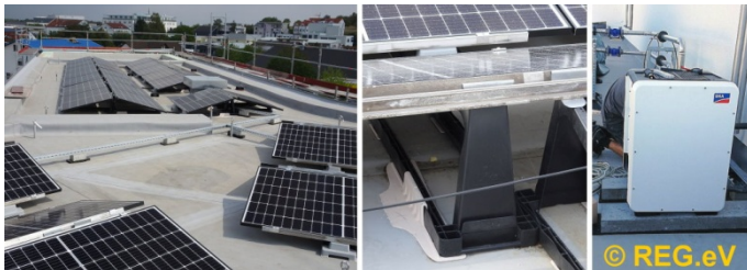
Bild (v. li.): Teilansicht PV-Anlage mit 2x drei Himmelsrichtungen; eine Klebestelle des Untergestells (weißer Kunststoff-Fuß); Wechselrichter für bis zu 50 Kilowatt Nennleistung
