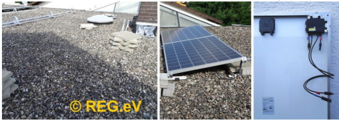
Bild (von links): Schatten auf Flachdach vom Nachbarhaus mit Schrägdach; Schatten auf PV-Modul hinten links; Leistungs-optimierer mit Kabeln oben rechts in Modulrahmen eingeschoben
