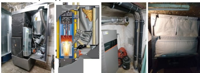
Bild: Pellet-Therme mit geöffneter Tür im Heizungsraum, Darstellung des Innenlebens, Leitungen zum Pellet-Transport aus Kellerraum, Pellet-Behälter mit Gewebe im Kellerraum (Fotos 1, 3 und 4: © REG.eV, Darstellung 2: aus Prospekt der Firma Guntamatic Heiztechnik GmbH, Peuerbach, Österreich)
