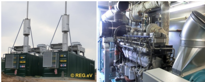
Bild: Blockheizkraftwerk auf dem Karlshof (zwei Einheiten) und ein Generator (rechts)
