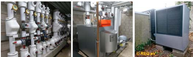
Bild: links Verteilung auf Heizkreise, mittig Gas-Brennwertheizung bis 246 kW, rechts Luft-/Wasser-Wärmepumpe bis zu 50 kW im Außenbereich
