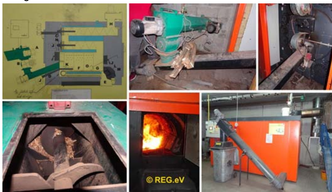
Bild (von li. oben nach re. unten): Schemabild der 300-kW-Heizung, Entnahme aus Bunker, Eintrag in Ofen, Transportschnecke, riesige Feuerstelle, Heizungskessel mit Ascheaustrag davor
