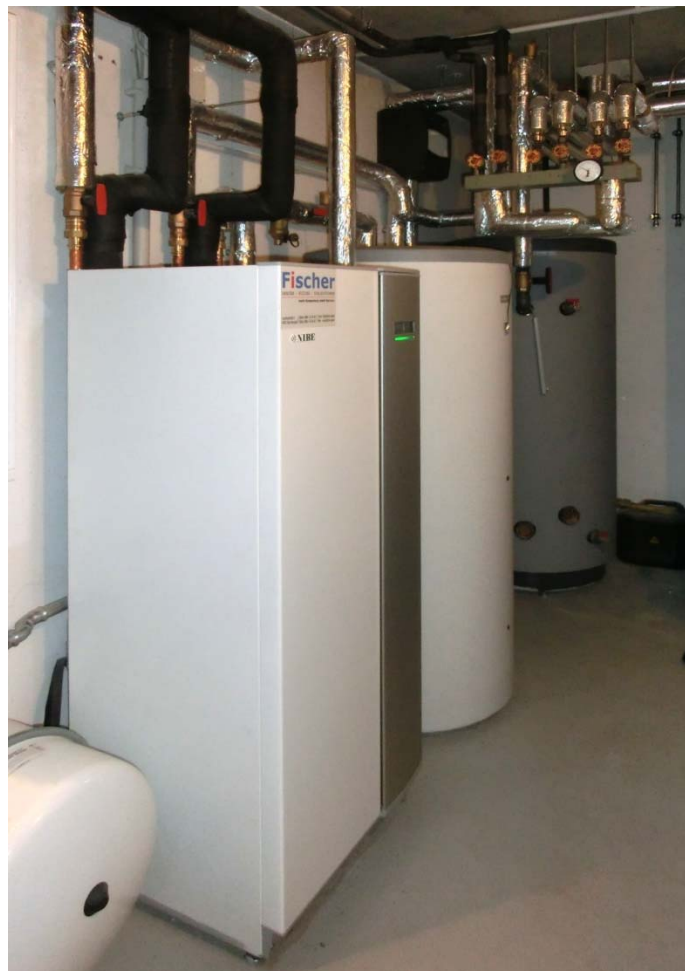
Erdwärme-Heizung in Roßdorf mit Wärmepumpenschrank, Heizungspufferspeicher und Warmwasserspeicher (v.li.)
