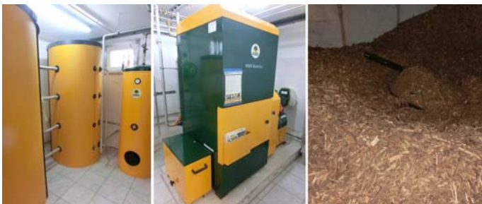
Holz hackschnitzelheizung (von li.) mit 2 Speichern für Heizung und 1 Warmwasserspeicher, Kessel mit Aschekasten links und Förderschnecke rechts, sowie Bunker für den Brennstoff
