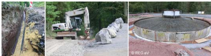
Bild: Weitere Kabel im Wald nördlich des Sportzentrums verlegt; Baggerarbeiten am nördlichen Bauplatz; „Zirkuszelt“ aus Stahl am südlichen Bauplatz hat jetzt einen Kragen zur Betonierung
