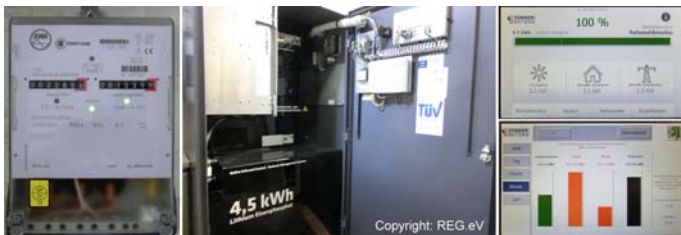
Batteriespeicher mit (v.l.) 2-Richtungs-Stromzähler, Schrank mit Batterie, Steuerung, Anzeige u. Internet-Verbindung sowie Beispiele der Anzeige
