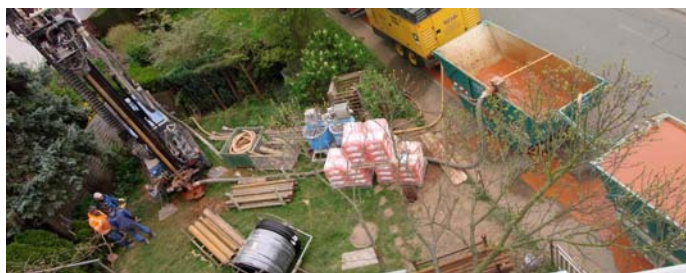
Bohrstelle in einem Garten in Gundernhausen mit Containern zur Wasser- und Abfallsammlung aus der Bohrung
