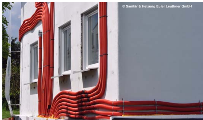
Bild: Fassade des Pfarrhauses 2 der Ev. Kirchengemeinde Roßdorf mit (noch) sichtbaren Lüftungsschläuchen
