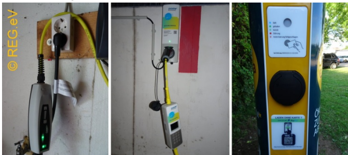
Bild: Ladeeinrichtungen in Roßdorf (v. li. privat an Schukosteckdose mit 2,3 kW; halböffentlich in der Tiefgarage Rathaus mit 3,7 kW; öffentlich in Gundershausen mit 2 x 22 kW)
