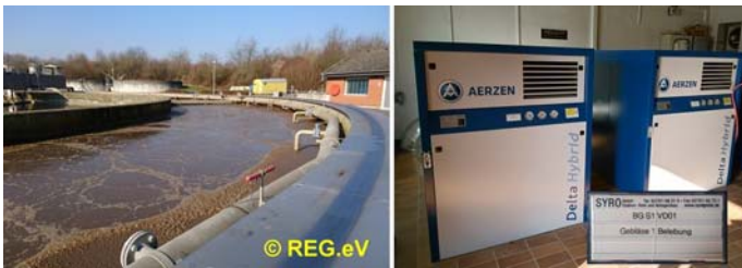
Bild: Links Teilansicht des runden Belebungsbeckens mit einer Ringleitung außen und nach unten abzweigenden Rohren zu den Belüftungen am Boden, rechts zwei der drei Gebläse mit geregelten Motoren per Frequenzumrichter
