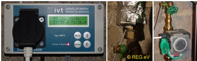
Bild: Steuerung, Temperaturfühler-Anschluss, Zirkulationspumpe
