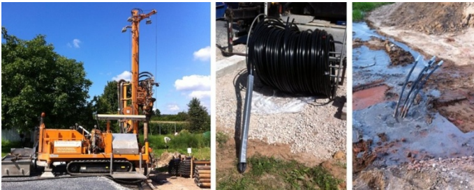
Bild (v. li.): Bohrfahrzeug ist angerückt, Sonde und Schlauch für das Bohrloch, vier Schläuche nach Räumung des Bohrplatzes
