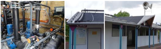
Bild (v. li. nach re.): Zwei der vier 11-kW-Pumpen im Technikraum, Solar-Absorber mit Sammelrohr, gesamte Dachfläche ist schwarz belegt
